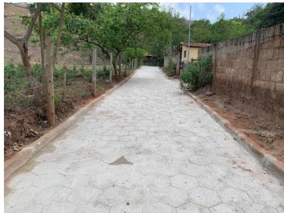
Calçamento da rua São Caetano executado sem apresentação de especificações técnicas (09/08/2020). Foto: Atingido de Paracatu de Baixo.
