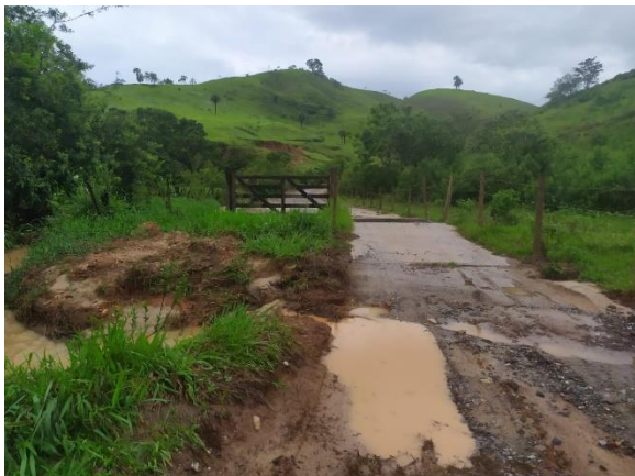
Conservação de estrada vicinal deficiente na Comunidade de Paracatu de Cima. Foto: Cáritas (02/2020).
