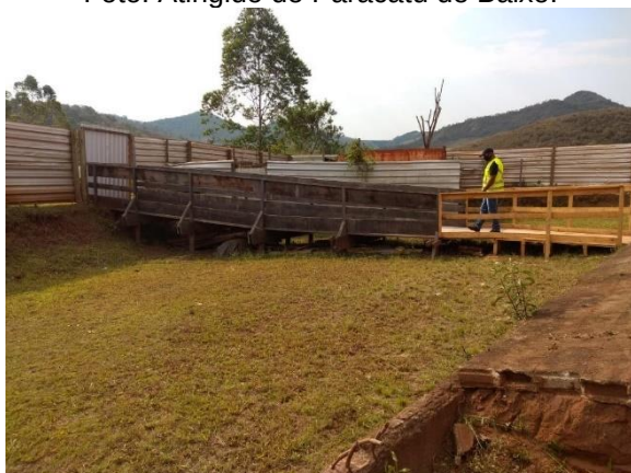
Passarela temporária de madeira no entorno da Igreja de Santo Antônio executada sem apresentação de especificações técnicas (08/10/2020). Foto: Karina Crepalde.
