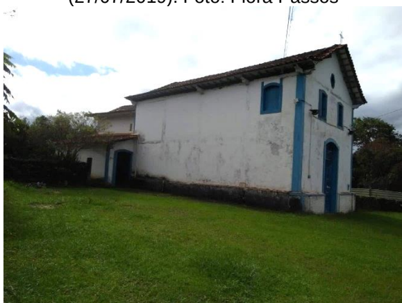
Situação precária da Capela de Nossa Senhora das Mercês (18/10/2020). Foto: Mauro Silva.
