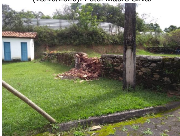
Desmoronamento de muro em canga seca do adro da Capela de Nossa Senhora das Mercês (18/10/2020). Foto: Mauro Silva.
