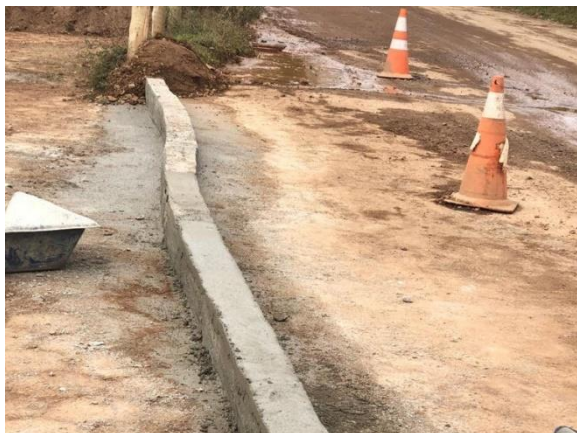
Intervenção executada indevidamente pela Fundação Renova no adro da Igreja de Santo Antônio (09/08/2020).
