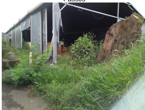
Situação de descaso com as ruínas da Capela de São Bento, com lona da estrutura rasgada e vegetação cobrindo e impedindo acesso (18/10/2020). Foto: Mauro Silva.
