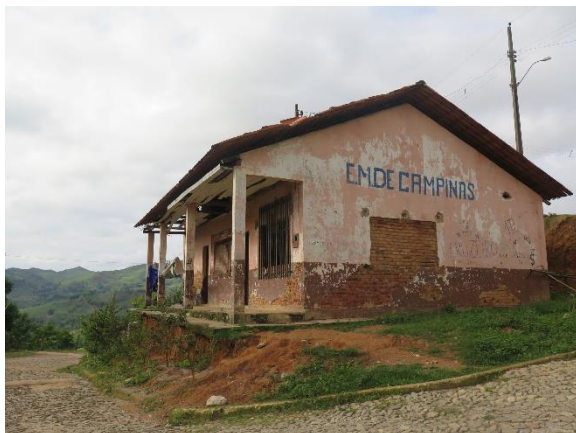
Antiga escola municipal de Campinas em estado precário de conservação (24/11/2018). Foto: Flora Passos.
