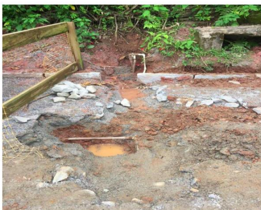
Problemas em tubulação de abastecimento de água (22/01/2020). Foto: Cáritas
