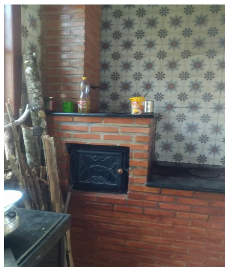
Figura 09 - Fogão a lenha pré-moldado fornecido pela Fundação Renova, apresentando falhas no funcionamento, Paracatu de Cima. Foto: Cáritas, 2022.
