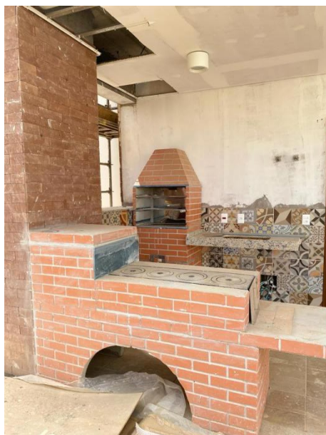
Figura 01 - Fogão a lenha pré moldado instalado nas casas do reassentamento de Bento Rodrigues. Foto: Cáritas, 2022.
