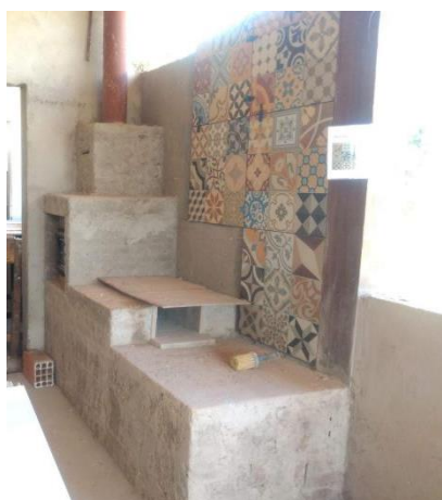
Figura 03 - Fogão a lenha em fase de construção in loco na comunidade de Paracatu de Cima. Foto: Cáritas, 2022.
