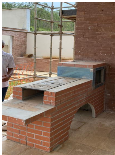
Figura 02 - Fogão a lenha pré moldado instalado nas casas do reassentamento de Bento Rodrigues. Foto: Cáritas, 2022.
