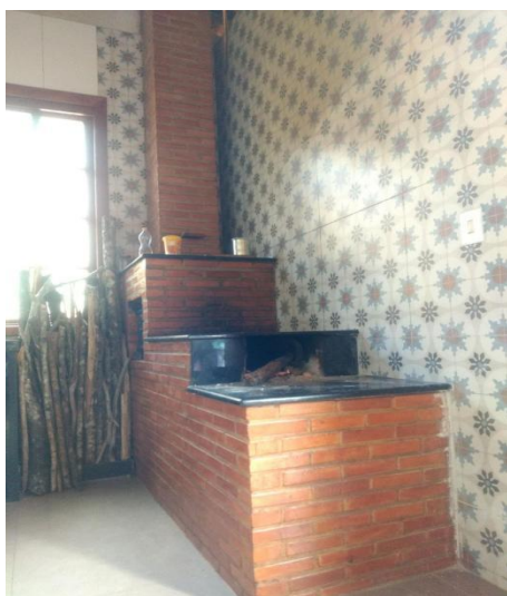
Figura 08 - Fogão a lenha pré-moldado fornecido pela Fundação Renova, apresentando falhas no funcionamento, Paracatu de Cima. Foto: Cáritas, 2022.
