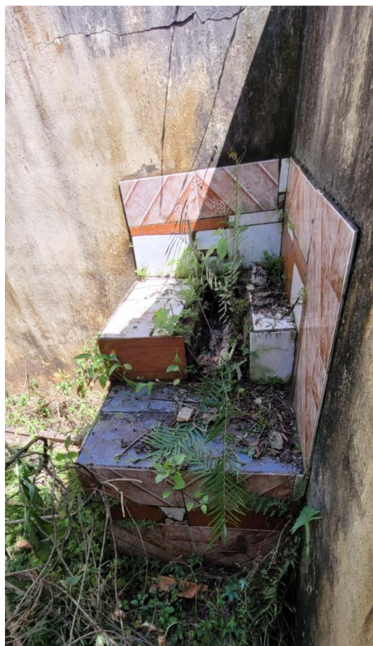
Figura 23 - Escombros de fogão a lenha em casa atingida pela lama de rejeitos da Barragem de Fundão - Bento Rodrigues. Foto: Mônica Santos, 2019.
