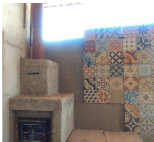
Figura 04 - Fogão a lenha em fase de construção in loco na comunidade de Paracatu de Cima. Foto: Cáritas, 2022.
