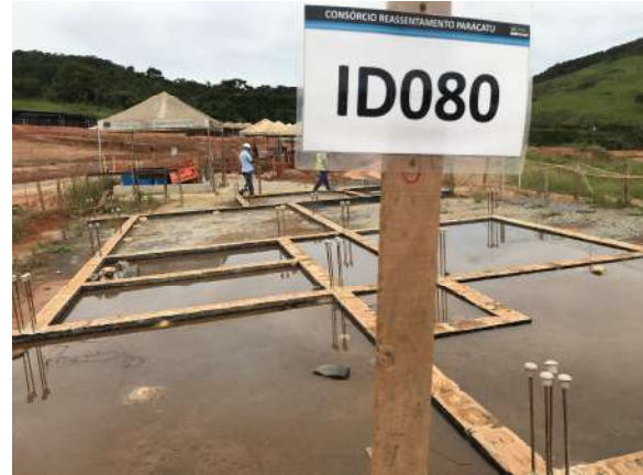
Água empossada em fundação finalizada. Data: 25/02/2021 . Fonte: Assessoria Técnica Cáritas.
