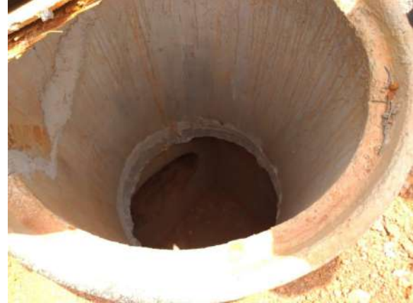
Tubulação de rede d'água pluvial - Área 1. Data: 08/10/2020 . Fonte: Assessoria Técnica Cáritas.
