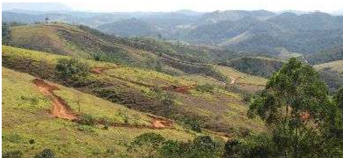
Vista geral da área destinada ao reassentamento coletivo de Paracatu de Baixo no início de execução das obras. Data: 31/07/2019 . Fonte: Assessoria Técnica Cáritas.
