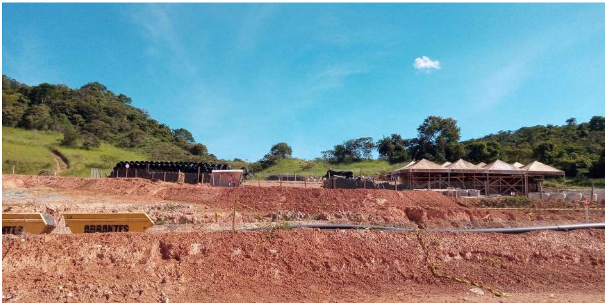
Tubulações estocadas na área 1, relativas ao desenvolvimento do sistema de abastecimento de água tratada e destinação do esgoto. Data: 04/03/2021 . Fonte: Assessoria Técnica Cáritas.
