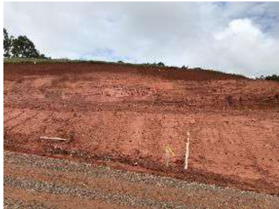
Taludes aos fundos de lotes. Data: 22/02/2021 . Fonte: Assessoria Técnica Cáritas.
