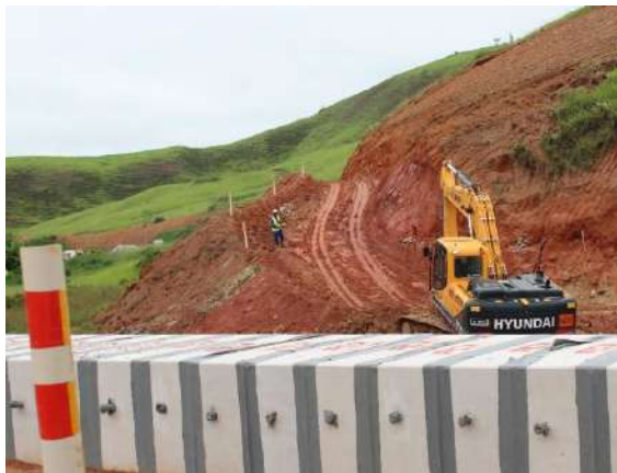
Serviços de terraplanagem em execução para a abertura da Rua São Caetano na Área 3. Data: 18/12/2019 . Fonte: Assessoria Técnica Cáritas.
