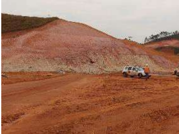
Taludes aos fundos de lotes. Data: 05/02/2020 . Fonte: Assessoria Técnica Cáritas.
