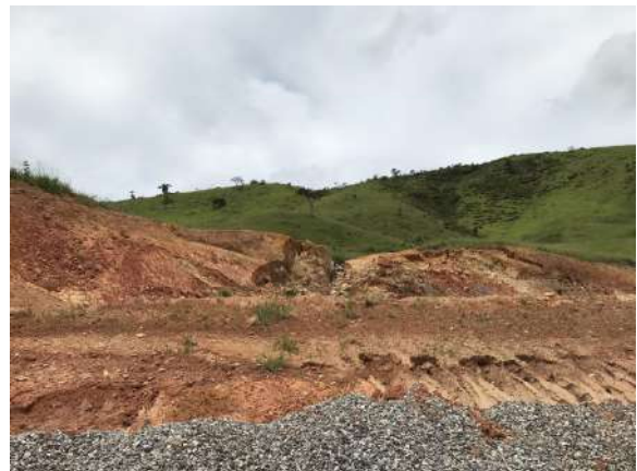
Serviços de terraplanagem ainda não finalizados em encosta próxima à Rua Monsenhor Horta. Data: 25/02/2021 . Fonte: Assessoria Técnica Cáritas.
