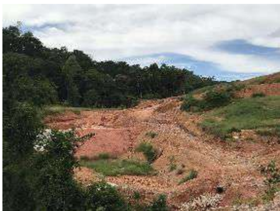
Trecho próximo à Rua Furquim (Área 2) com serviços de terraplanagem necessários, mas sem
