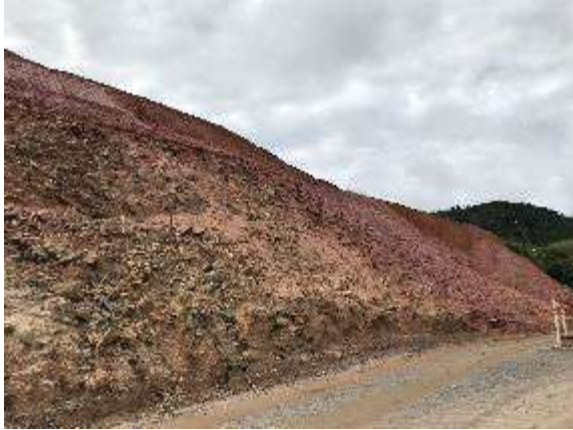
Encosta ainda sem execução de contenção e proteção. Data: 22/02/2021 . Fonte: Assessoria Técnica Cáritas.
