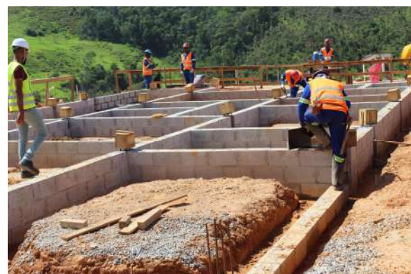
Fundação de moradia executada em sapata corrida. Data: 18/12/2019 . Fonte: Assessoria Técnica Cáritas.
