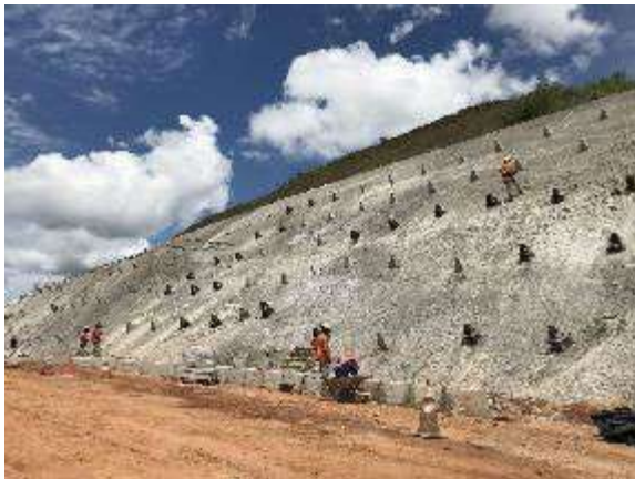
Serviços de contenção de taludes do acesso principal ("trincheira") ainda em execução. Data: 25/02/2021 . Fonte: Assessoria Técnica Cáritas.
