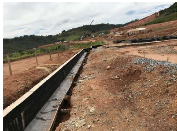
Muro de arrimo executado em parte aterrada da Área 1, no interior de um lote, mas sem proposta de contenção no limite do lote onde existe encosta. Data: 25/02/2021 . Fonte: Assessoria Técnica Cáritas.
