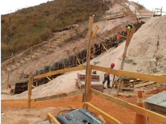
Execução de dissipador de água - acesso principal. Data: 08/10/2020 . Fonte: Assessoria Técnica Cáritas.
