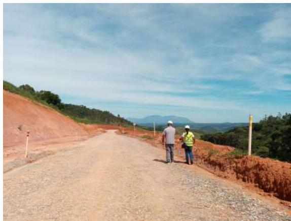
Rua Furquim ainda sem pavimentação. Data: 05/12/2020 . Fonte: Assessoria técnica da Cáritas
