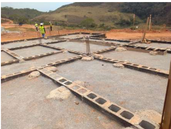
Vista parcial de fundação finalizada, na área 1. Data: 08/10/2020 . Fonte: Assessoria Técnica Cáritas.
