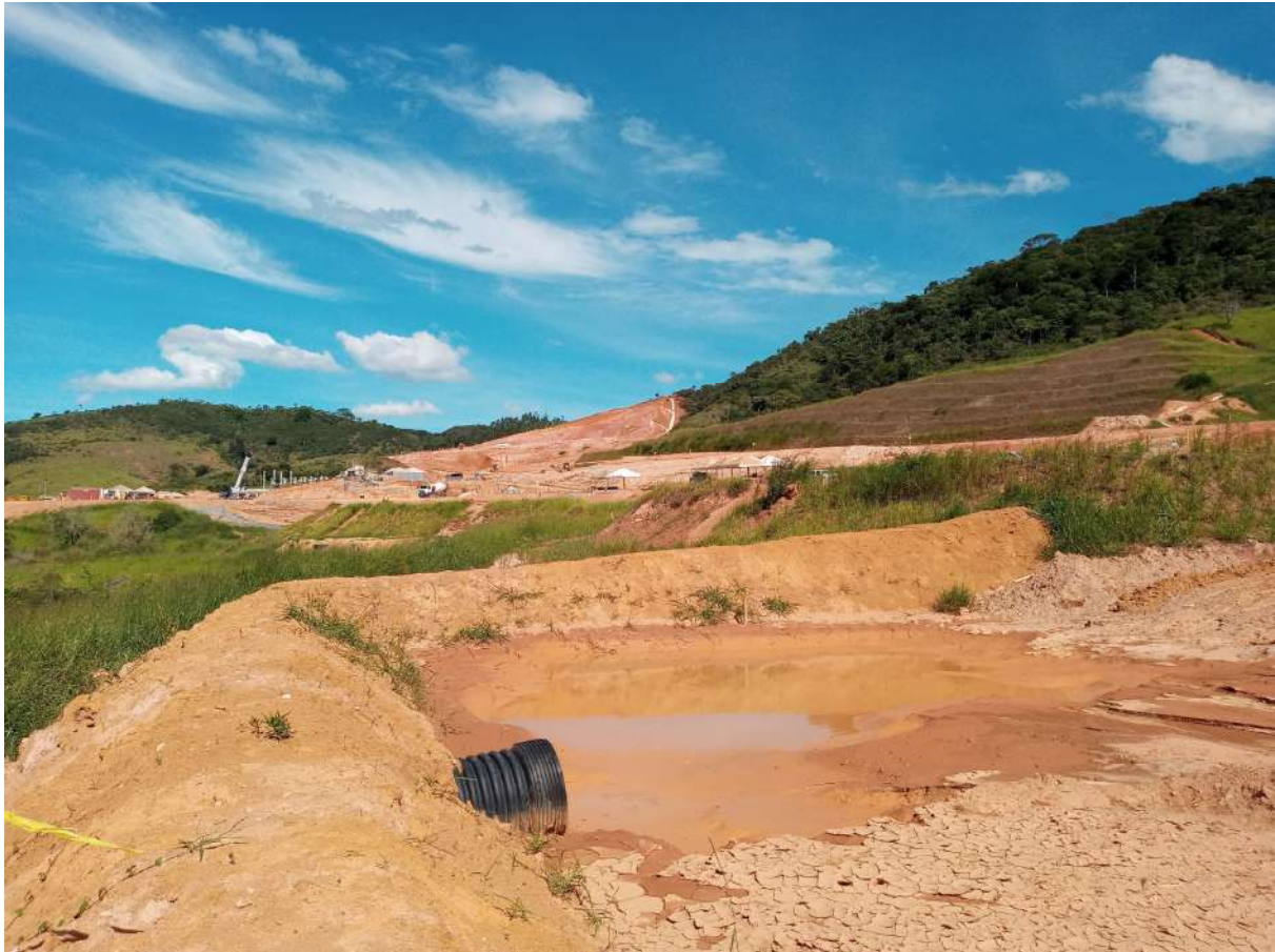
Sistema de drenagem provisória situado dentro do lote de um núcleo familiar. Data: 04/03/2021 . Fonte: Assessoria Técnica Cáritas.
