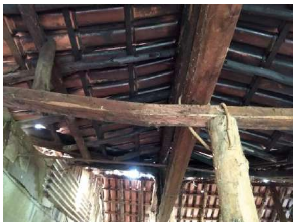
Patologia na estrutura do telhado de casa utilizada como ponto de apoio às obras de reparação. Data: 11/02/2020 . Fonte: Cáritas MG.
