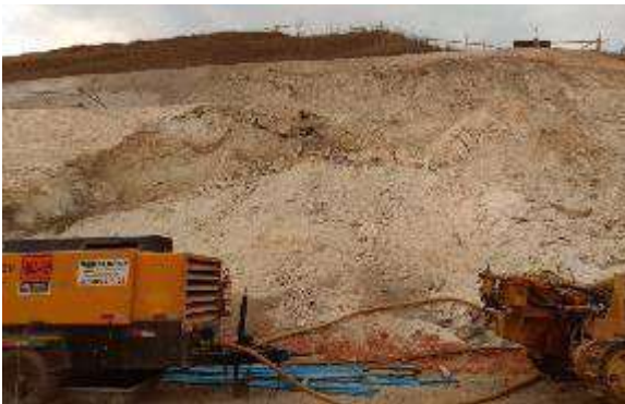
Deslizamento em talude no acesso. Data: 08/10/2020 . Fonte: Assessoria Técnica Cáritas.
