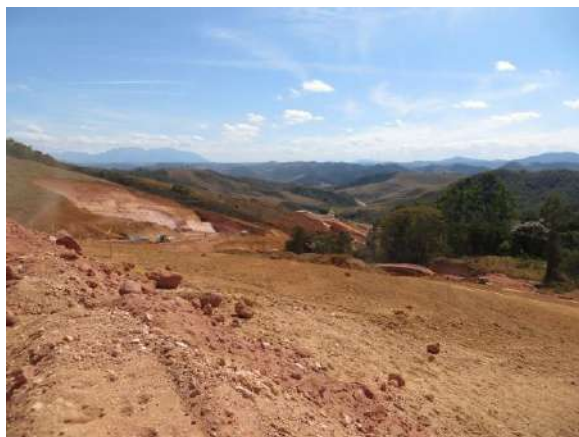
Intervenções paralisadas no início da Rua Furquim. Data: 05/08/2021 . Fonte: Assessoria Técnica Cáritas.
