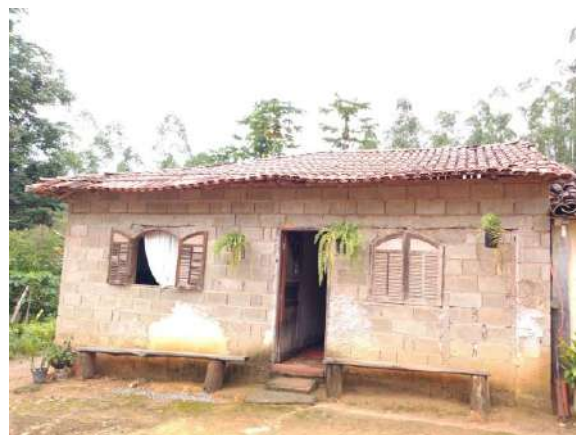
Recalque no telhado devido a dano estrutural. Data: 11/02/2020 . Fonte: Cáritas MG.
